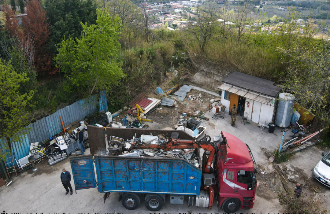
Un camion rosso con un contenitore blu viene caricato con rifiuti da un escavatore giallo in un'area all'aperto. Sullo sfondo si vede un piccolo edificio bianco, un serbatoio d'acqua blu e un'auto bianca. L'area è piena di rifiuti e detriti. Sullo sfondo si vede un'area residenziale con case e alberi su un pendio.
